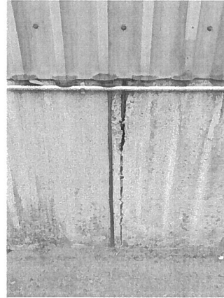
Kuva nro 8 sokkelin saumat ovat paikoin halkeilleet
