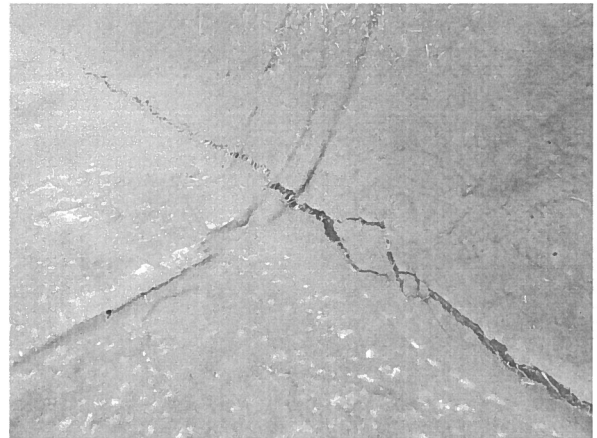
Kuva nro 19 vesikate rikkoutunut
