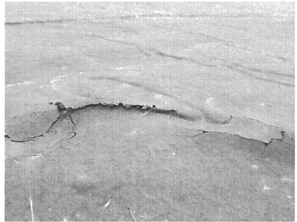
Kuva nro 21 vesikate rikkoutunut
