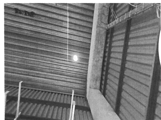
Kuva 27 vesikatossa reikä hallin kohdalla
