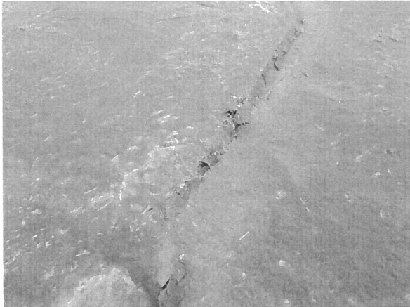
Kuva nro 22 vesikate rikkoutunut
