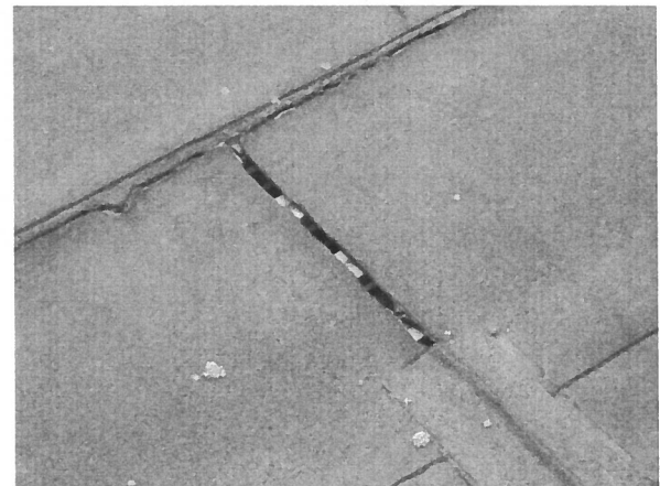
Kuva nro 25 sadevedet pääsevät kulkeutumaan rakenteeseen
