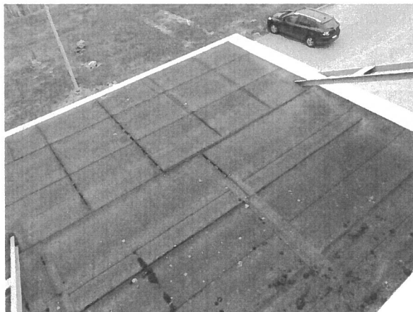
Kuva nro 24 katoksen katteet irronneet saumakohtistaan
