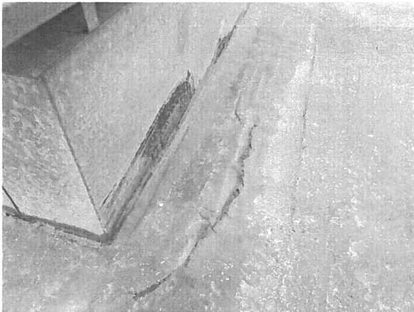
Kuva nro 20 vesikate rikkoutunut
