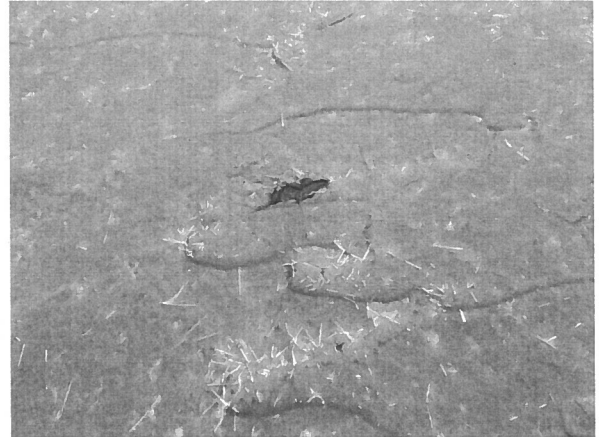
Kuva nro 23 vesikate rikkoutunut
