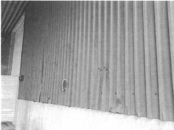
Kuva nro 15 peltiseinä paikoin rikkoutunut
