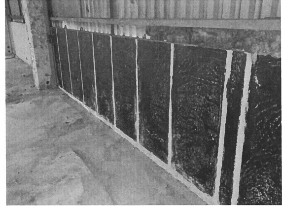
Kuva nro 10 seinäpinnalla havaittavissa pikisivelyä puretun tilan kohdalla (tila ollut ilmeisesti lämpöeristetty)
